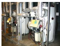
[既設ボイラー]
